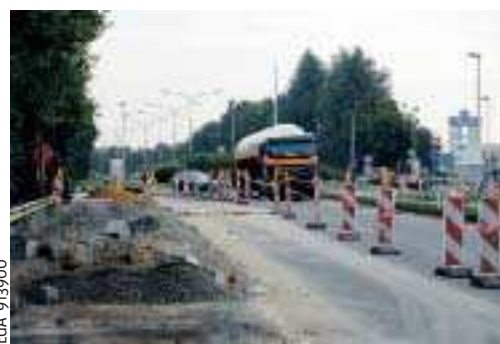
La mise à deux voies de l'entrée des ronds-points du contournement Sud devrait réduire le trafic aux abords du zoning.
